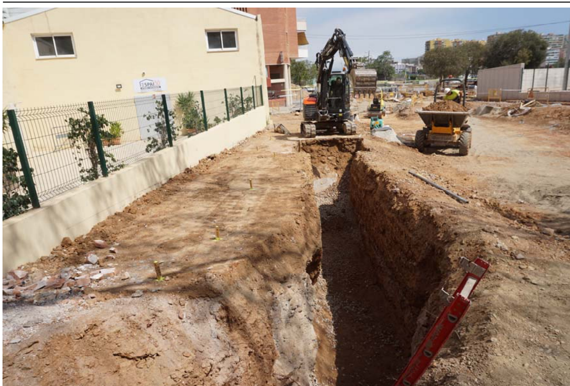
Fig.21 Feines de rebaix de la rasa I per la construcció de serveis.
