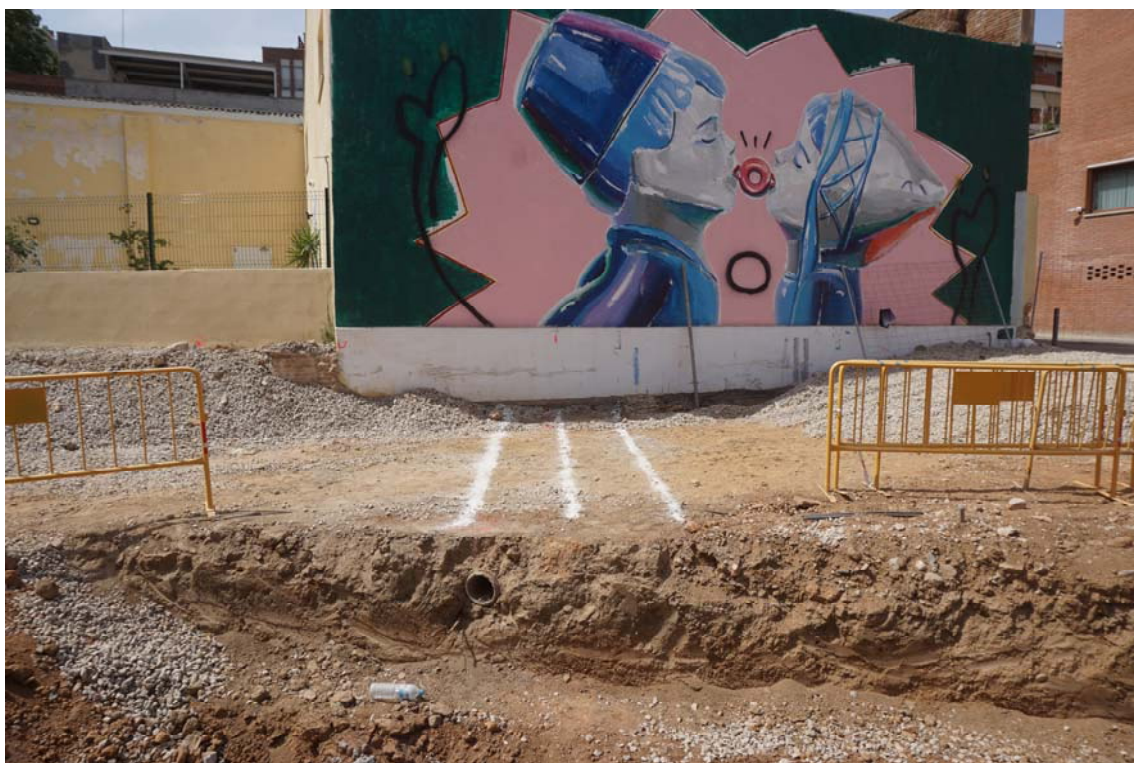
Fig.23 Detall del plantejament de la rasa III per la construcció de serveis.
